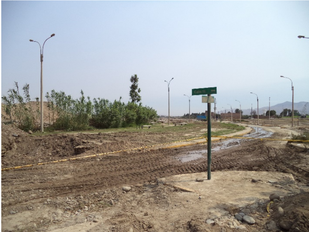
Figura 28. Parques y veredas de la urbanización Los Álamos, afectadas por la inundación del río.
