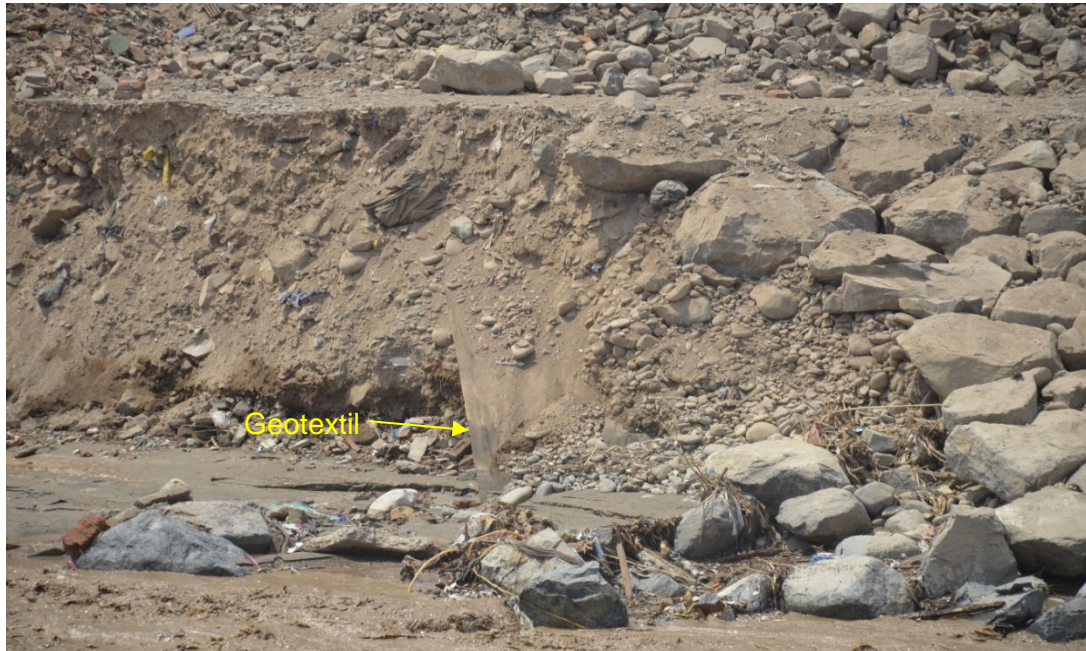
Figura 38. Ampliación del extremo de empotramiento del enrocado de la margen izquierda. Con la pérdida del material de relleno, la defensa expone su sección transversal y parte del geotextil.
