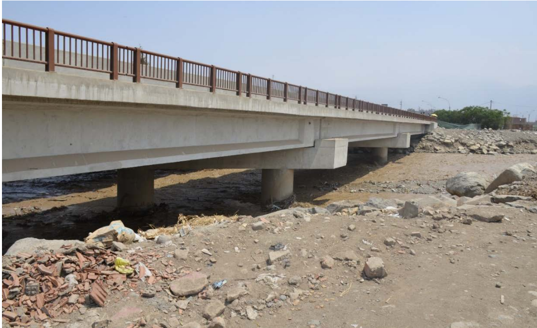
Figura 36. Vista aguas arriba del puente La Rinconada, es viajada con respecto a flujo en un ángulo estimado de 45°. Los enrocados de encauzamiento han sido construidos alineándose al terreno existente antes de la ocurrencia de las avenidas.
