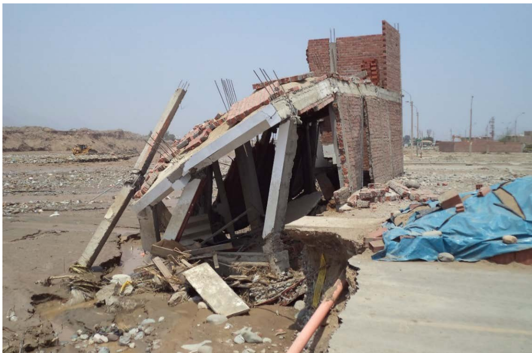
Figura 16. Vivienda de 2 pisos colapsada por la erosión de la terraza sobre la cual estaba construida.
