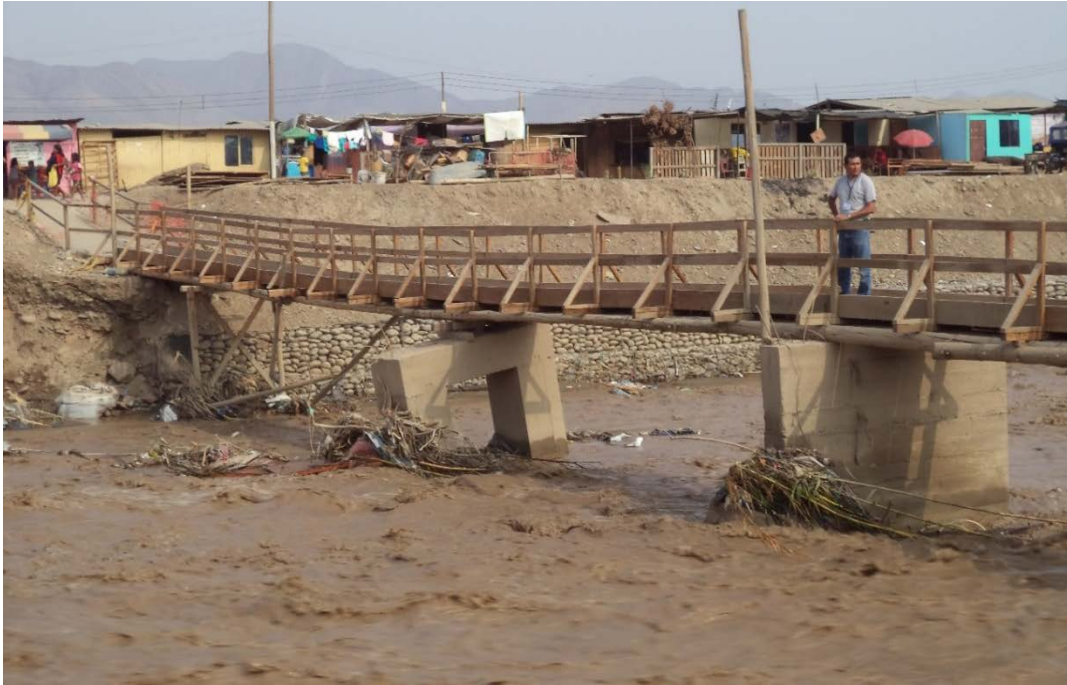
Figura 30. Puente peatonal en el A.H. Los Gallinazos. Se observa un pilar de concreto inestable y un soporte de madera.
