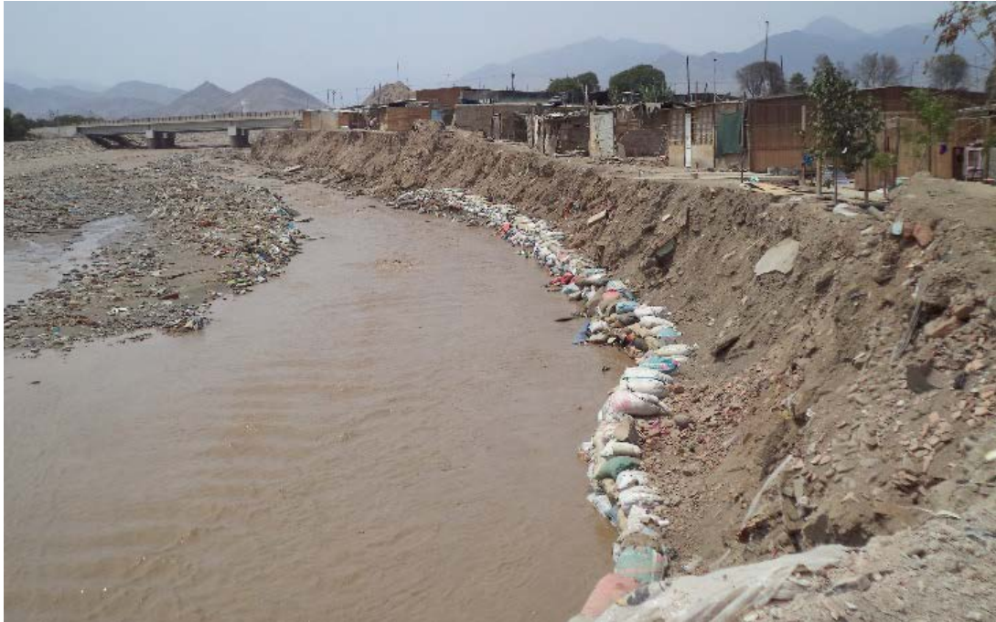
Figura 23. A.H. Fujimori Fujimori ubicado en la margen izquierda del río Chillón y cuyo suelo es un material de relleno. En la parte inferior de la ladera se observan costales con arena colocados por los pobladores para evitar la erosión de la ladera.
