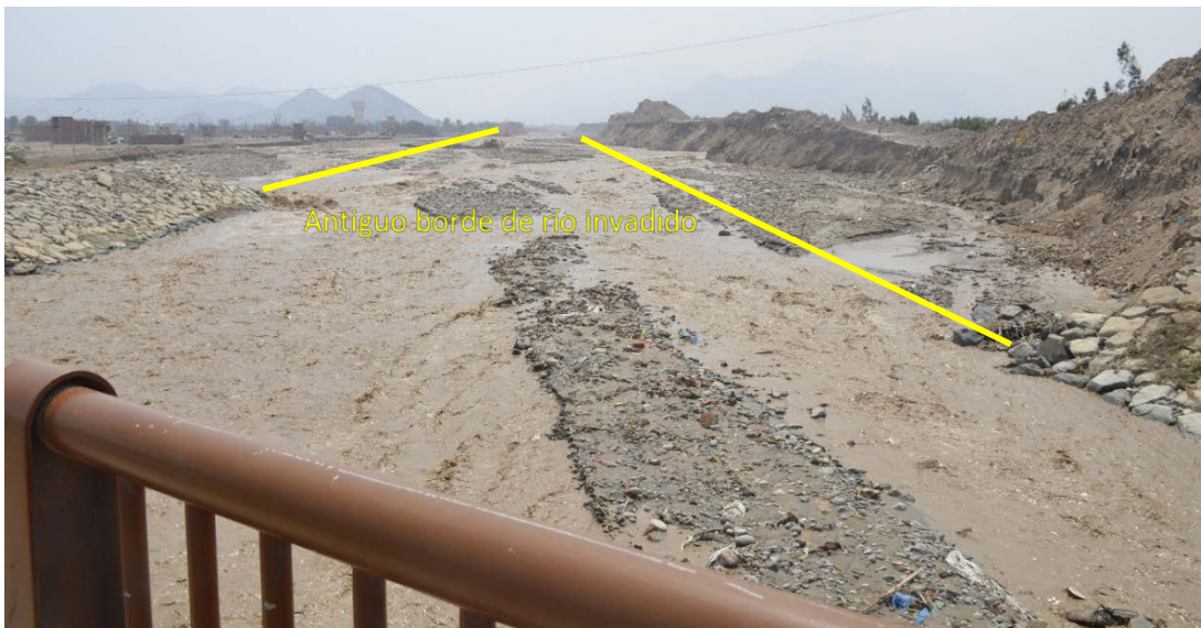
Figura 37. Vista aguas arriba del puente La Rinconada. Cambio de las características del cauce, el material de relleno han sido erosionados y los empotramientos del encauzamiento quedaron descubiertos con riesgos a destrucción de los enrocados.
