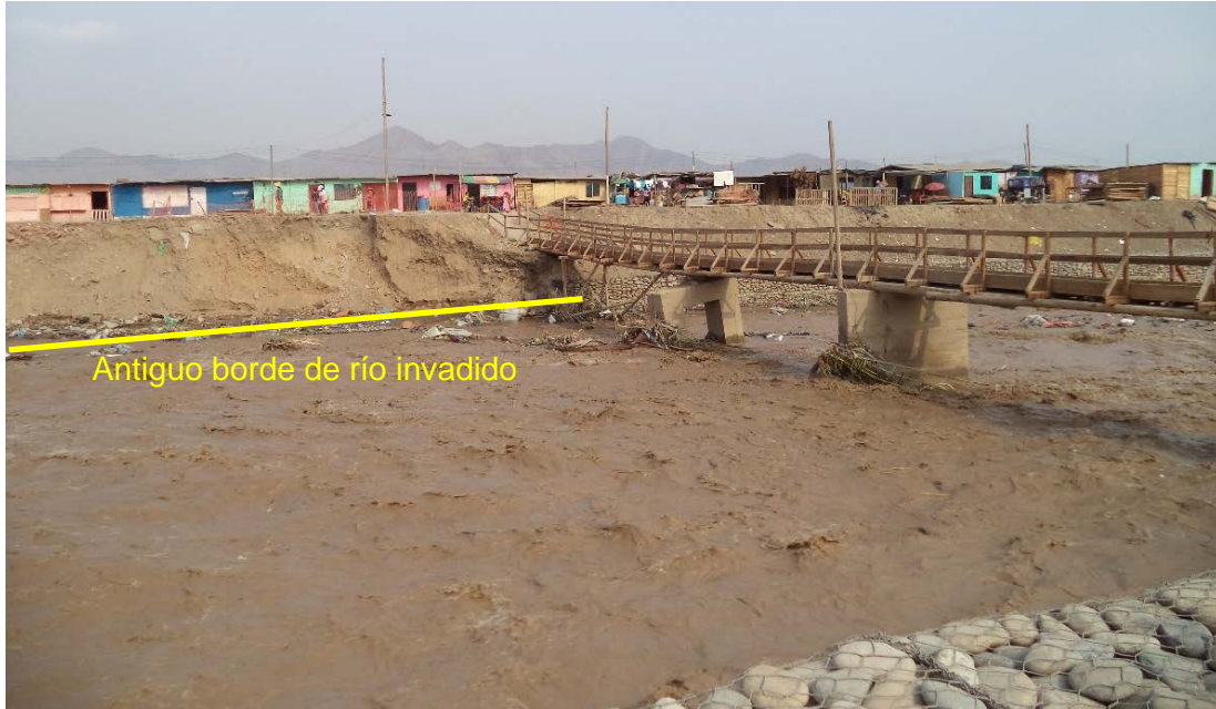
Figura 44. Falla por socavación del apoyo central del puente peatonal. En este tramo el río ha sido estrechado a un ancho aproximado de 40 m, incrementando las velocidades erosivas.
