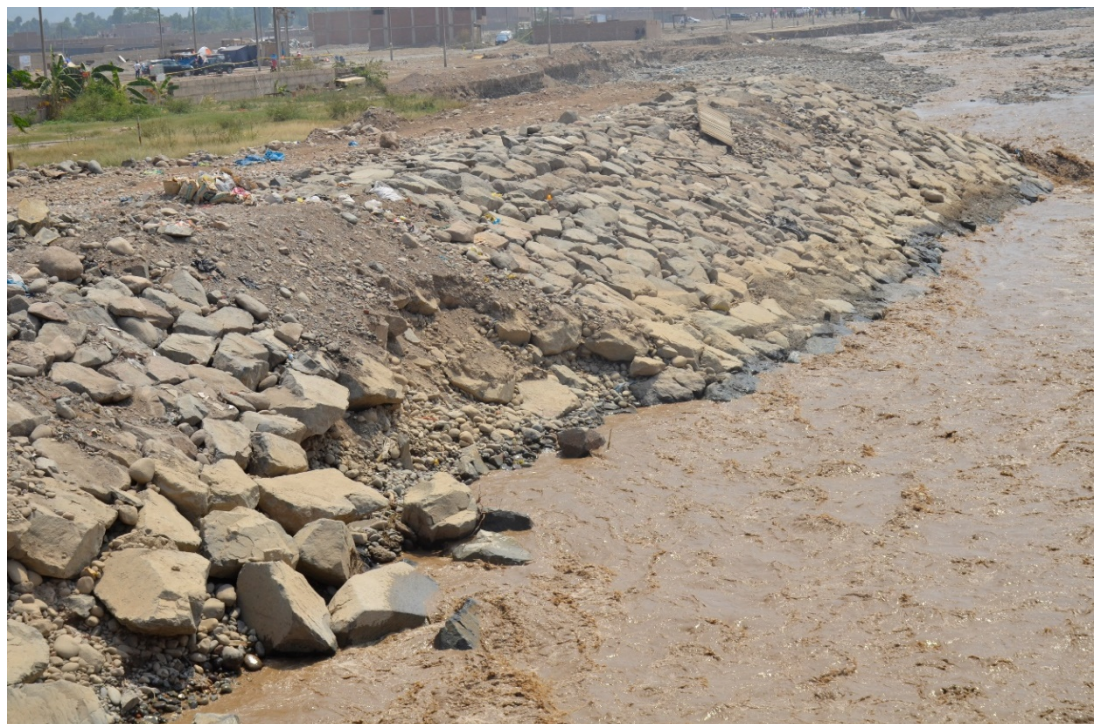
Figura 19. Ladera derecha del río Chillón protegida con un enrocado. Se puede observar que parte del enrocado ha sido removido dejándolo inestable y expuesto a la erosión fluvial.
