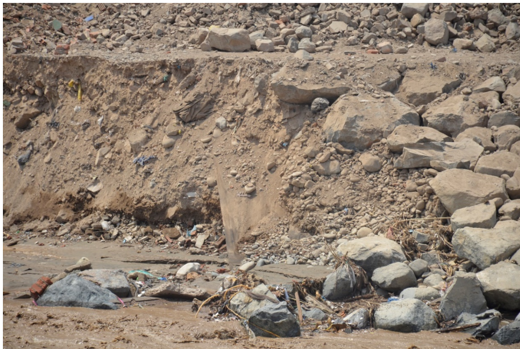
Figura 21. Ladera izquierda del río Chillón, cuya parte lateral del enrocado está siendo erosionado.
