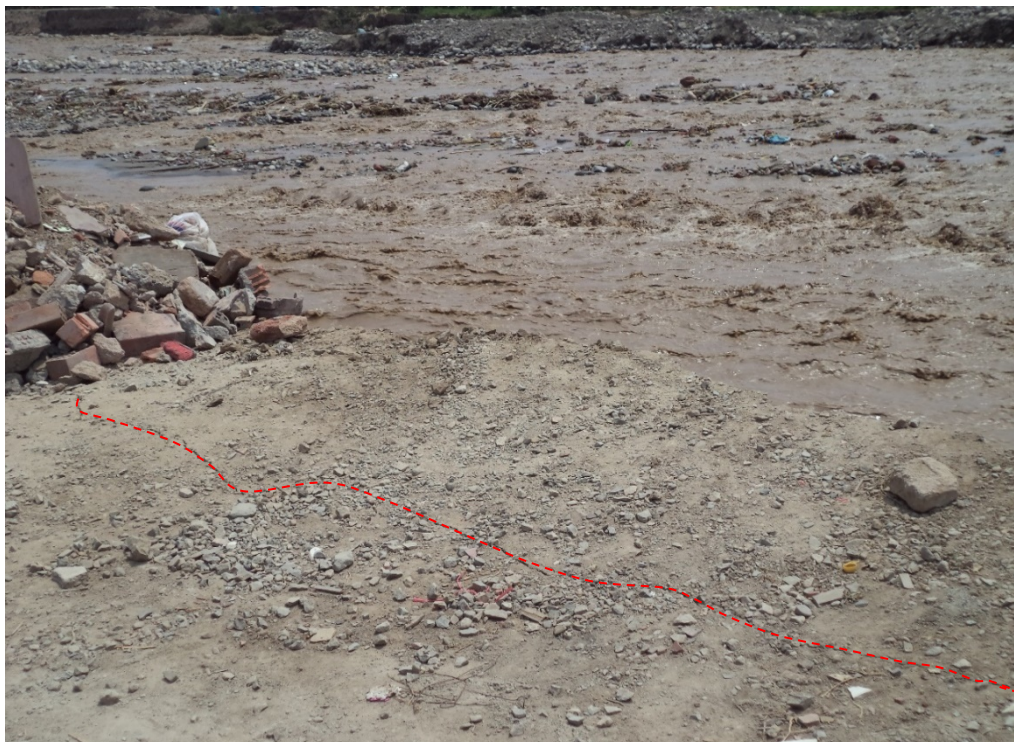
Figura 24. Grieta en el suelo, lo que evidencia la inestabilidad de la ladera.
